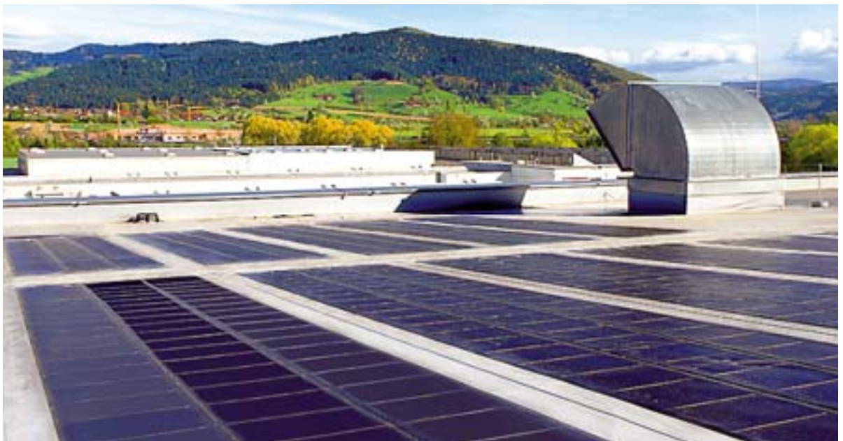
Auf dem Dach des Unternehmensgebäudes befindet sich eine Photovoltaikanlage.
